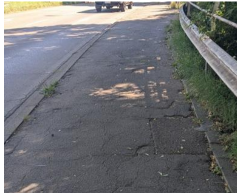
Abbildung 30: Schäden an der Belags- oberfläche
