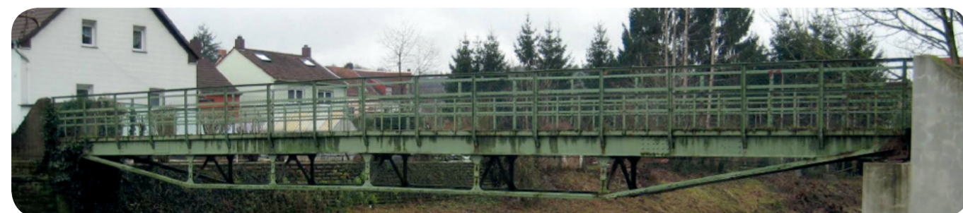
Die gesperrte Brücke Stegwiesen
